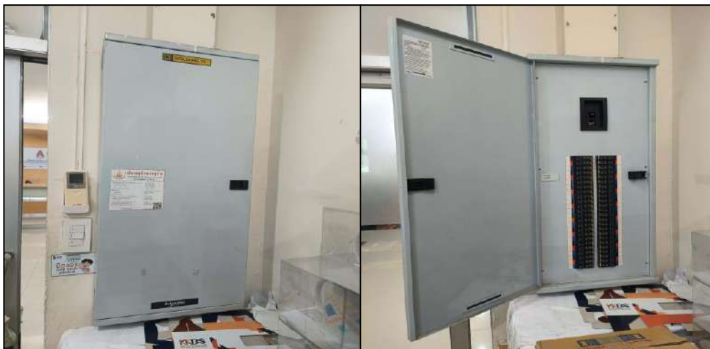
ภาพที่ 37 ตู้โหลดเซ็นเตอร์ (Load Center)
