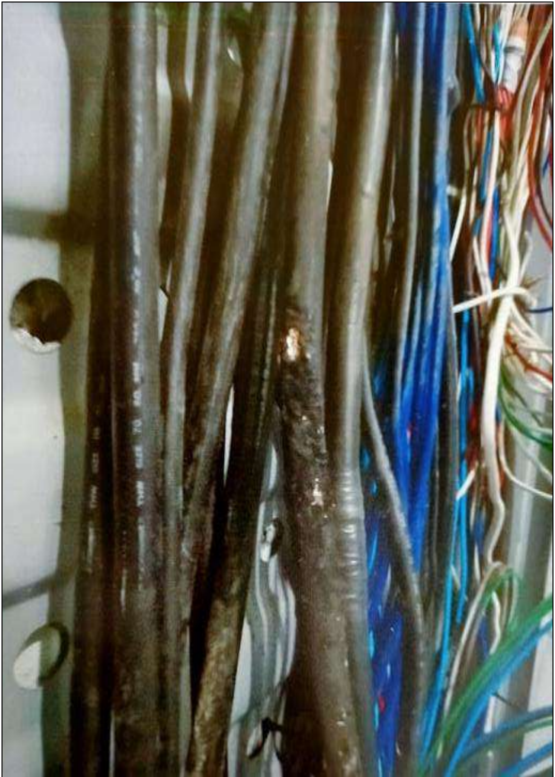
ภาพที่ 65 แสดงการสำรวจความเสียหายสายไฟป้อนขั้วรถโดยหนูกัดสายไฟ
