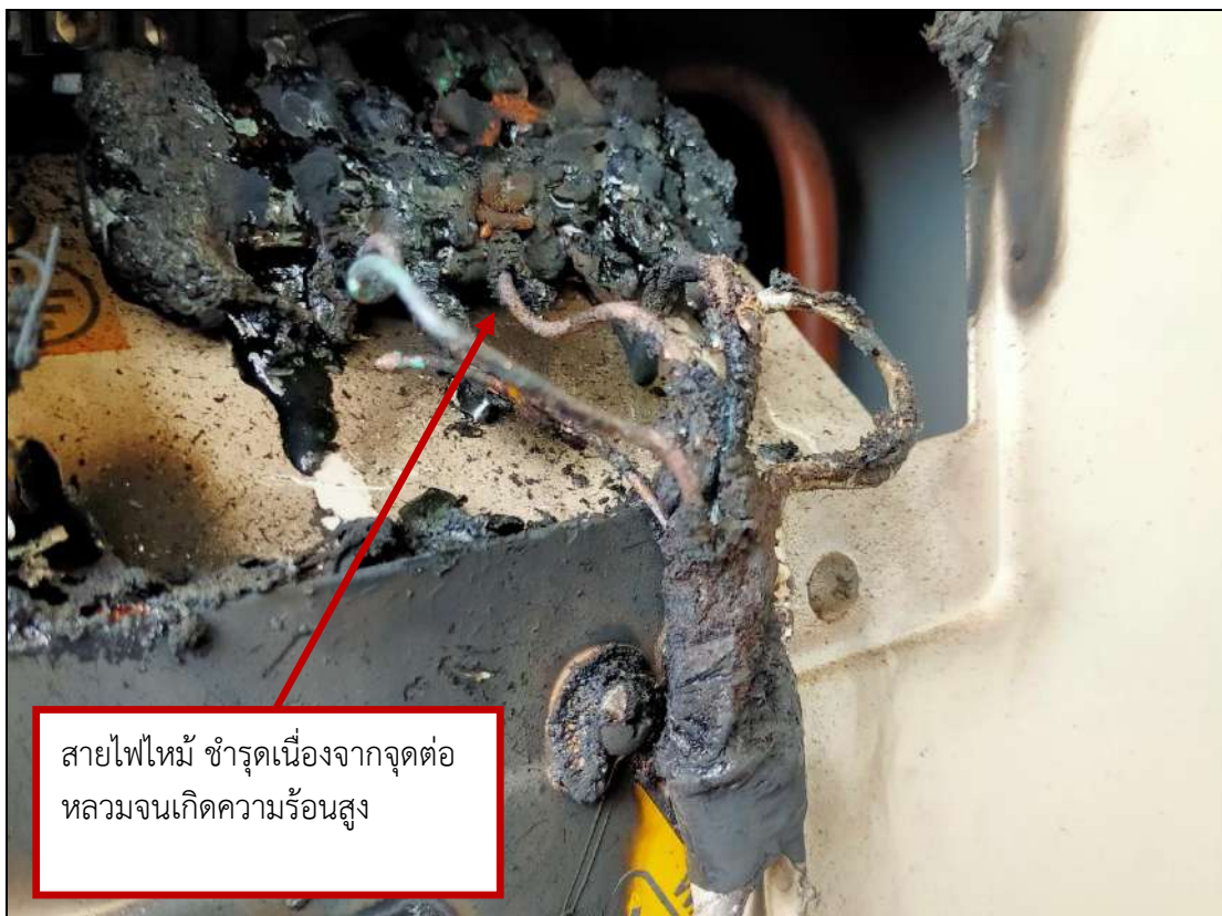
ภาพที่ 64 แสดงการสำรวจความเสียหายในเขตพื้นที่จริง ( สายไฟเครื่องปรับอากาศใหม่)
