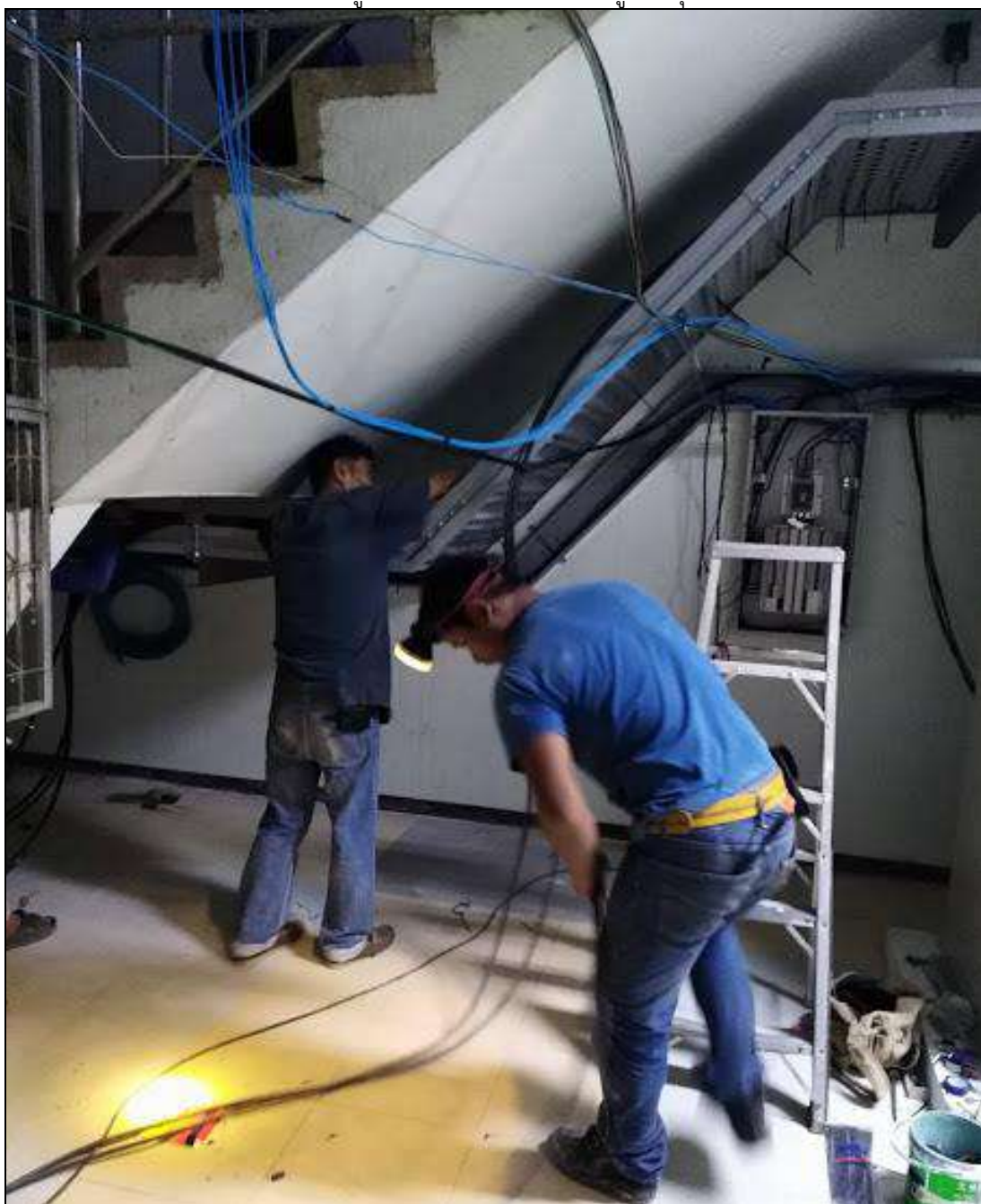
ภาพที่ 87 แสดงผู้รับจ้างเข้าดำเนินการย้ายตู้ควบคุมไฟฟ้า MDB
